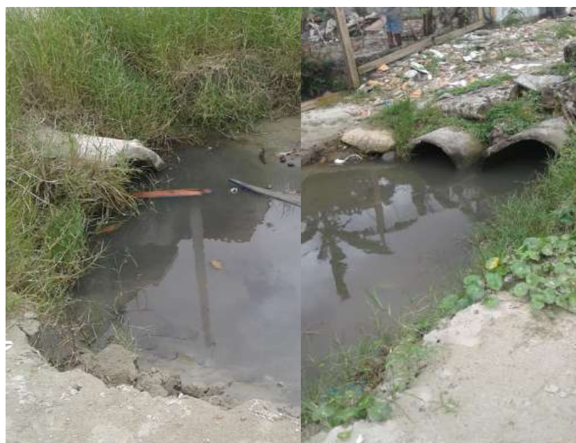
Figura 3: Galerias de águas pluviais despejando água suja no corpo hídrico
