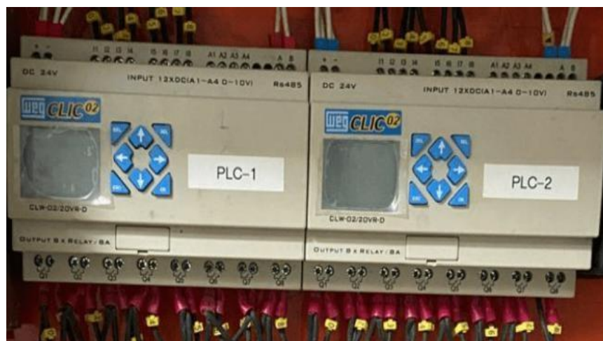
Figura 2: CLPs 01 e 02 de comando do sistema “Safety Pipes”, conectados em rede Modbus RTU no modo mestre-escravo.
