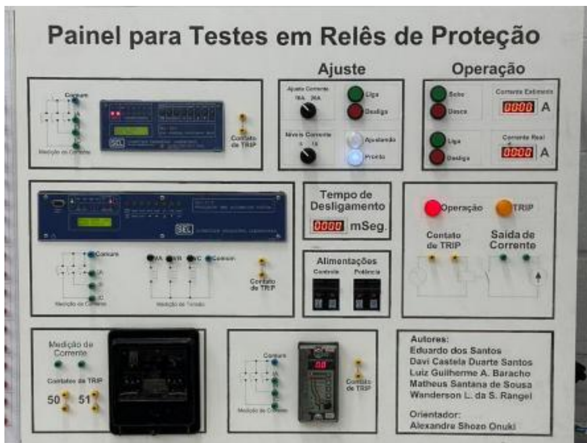
Figura 05 – Painel em operação
