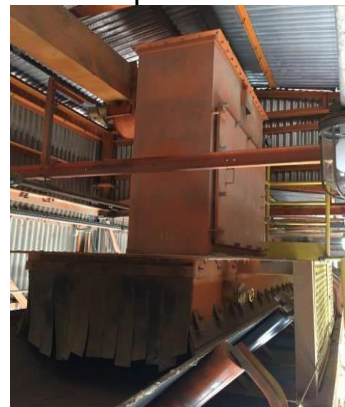
Figura 2 – Filtro compacto implantado linhas de transportadores do terminal
