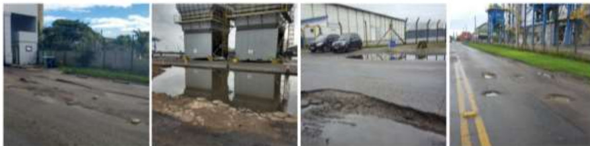
Figura 2 – Antes das obras de manutenção das vias do Porto de Imbituba
