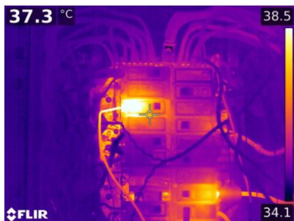
Figura 1. Exemplo do uso da termografia em um quadro de distribuição [5].
