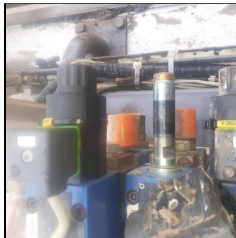
Figura 9. Válvula em curto circuito (Fonte: os autores)
