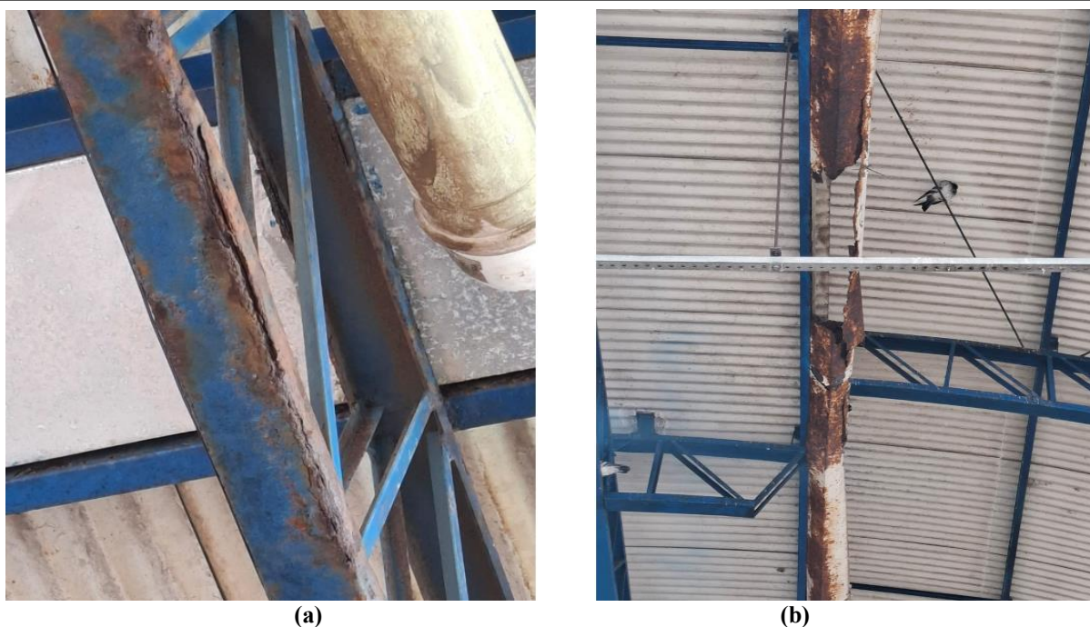
Figura 7. Manifestações patológicas observadas in loco na estrutura metálica avaliada: (a) corrosão atmosférica avançada em elemento da cobertura, com degradação do revestimento protetor e perda localizada de seção; (b) corrosão severa em elemento estrutural da cobertura, com redução significativa da seção transversal.
