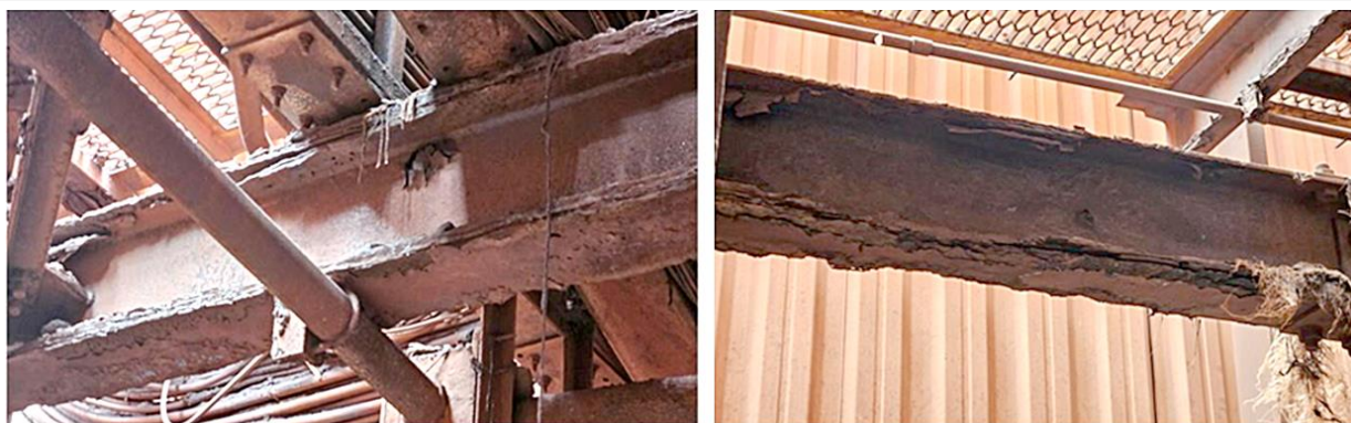
Figura 2. Exemplos da atuação de processos de corrosão em vigas de apoio de correias transportadoras.
