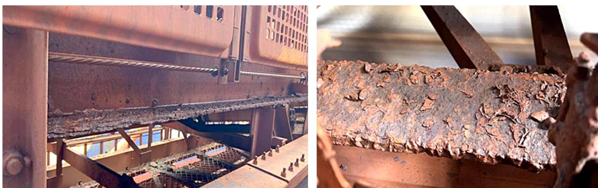
Figura 3. Exemplos de processos de corrosão em treliças de sustentação de correias transportadoras.
