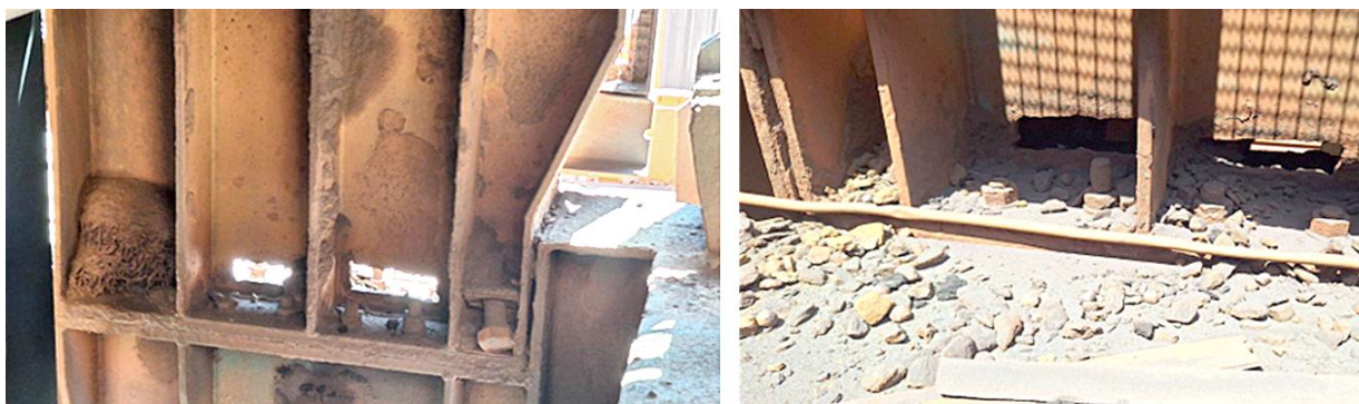
Figura 4. Exemplos de processos de corrosão em bases metálicas e obras civis de correias transportadoras.
